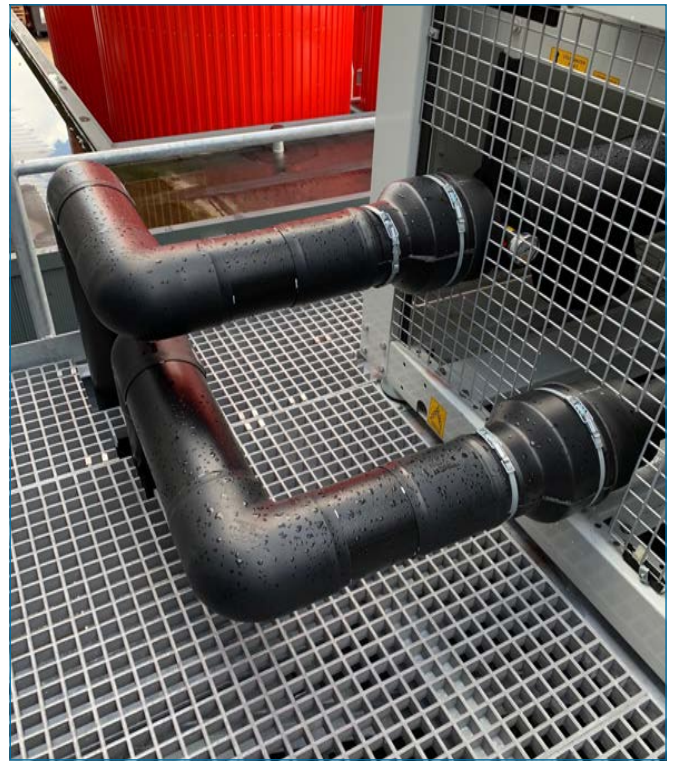
COOL-FIT 4.0 aansluiting op chiller
