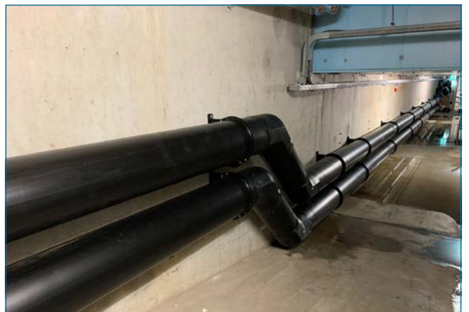
COOL-FIT 4.0 klimaatleidingen in een ziekenhuis
