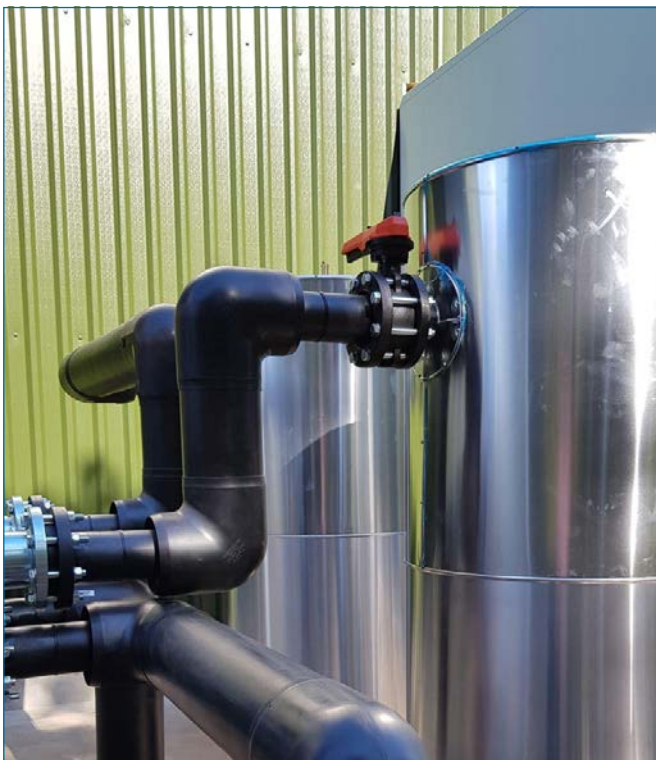
COOL-FIT 4.0 aansluiting op buffervat met vlinderklep
