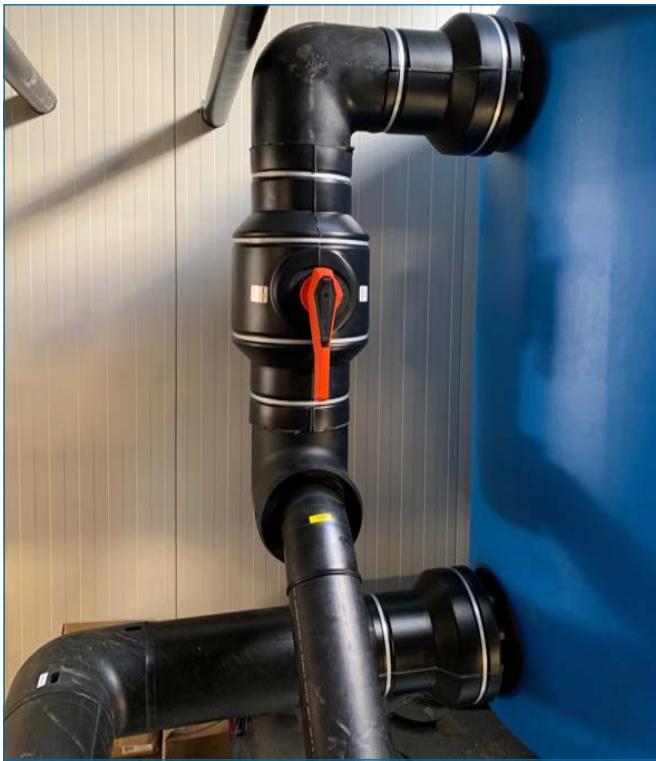
COOL-FIT 4.0 aansluiting op buffervat
